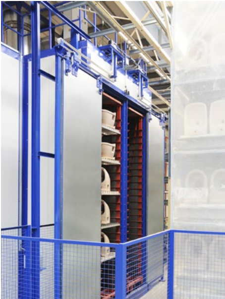
Trocknereinfahrt Dryer entrance
