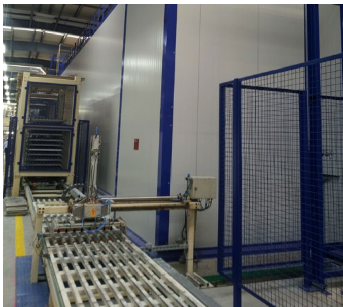
Trocknereinfahrt mit Palettenrücklauf Dryer entrance with pallet return conveyer
