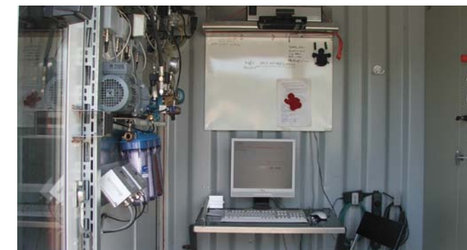
Steuerraum Control room
