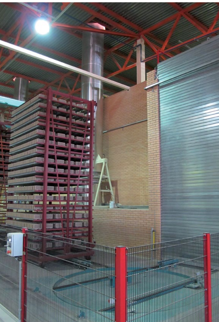
Dryer exit выезд из сушилки
