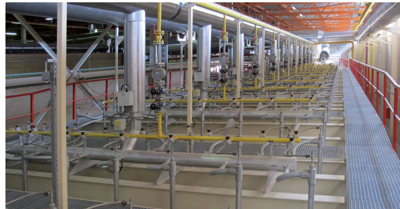
Gas firing installation of the tunnel kiln газовая горелочная установка туннельной печи
