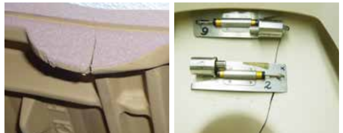
Возможные дефекты Mögliche Schadensfälle
