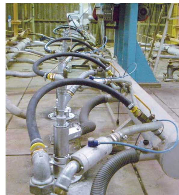
Festbrennstoff-Feuerung Solid fuel firing system
