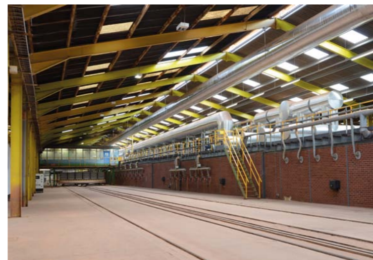
Tunnelöfen für Verblendziegel Tunnel kilns for face bricks
