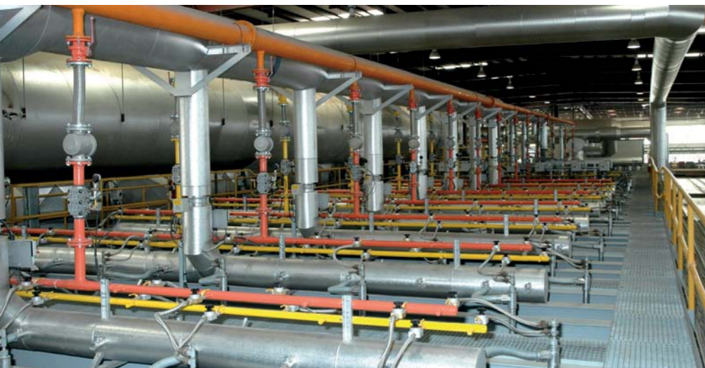
Dualbrennanlage für Biogas und Erdgas Dual fuel firing system for landfill gas and natural gas
