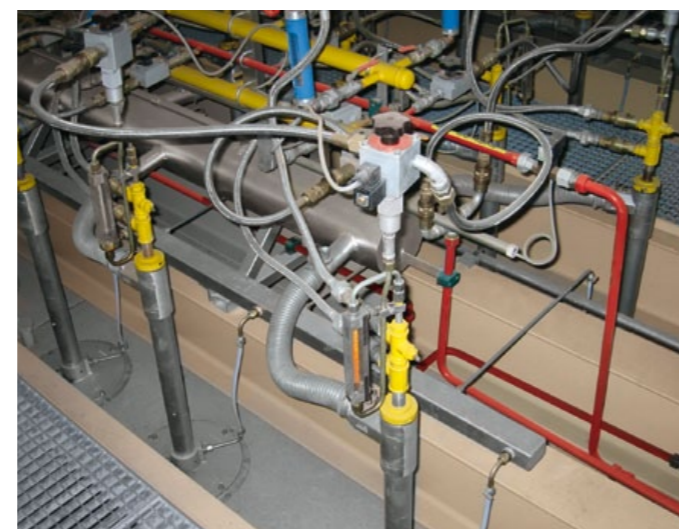
Dual fuel firing system for vegetable oil and natural gas Installation de chauffage double à huile végétale et gaz naturel
