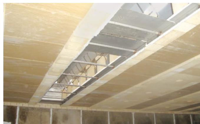
Modular kiln – wall and roof refractory lining Four modulaire – revêtement en matériaux réfractaires des murs et de la voûte
