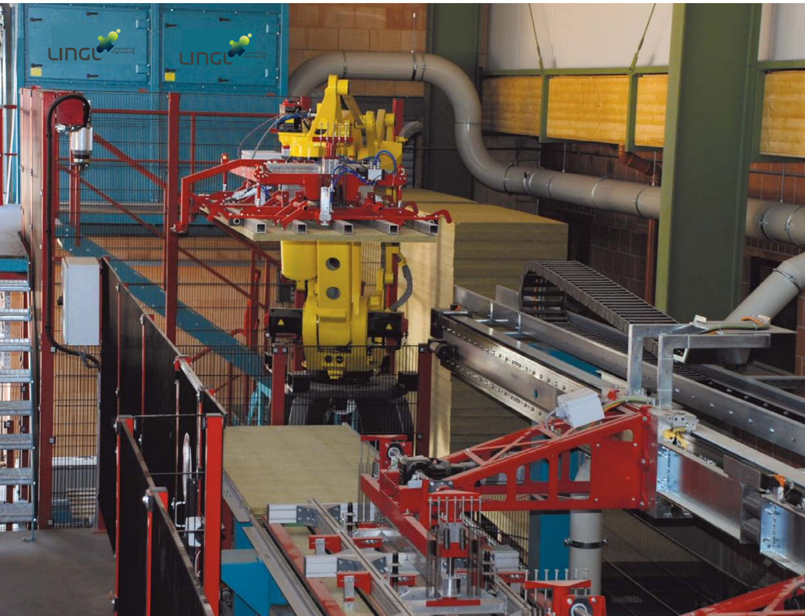
Gesamtansicht Absauganlage und Mineralwollmattenhandling General view dust extraction unit and mineral wool sheet handling
