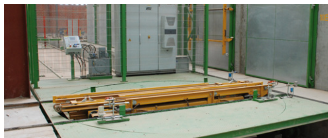
Transbordeur – séchoir à chambres Transfer car – chamber dryer
